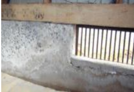
劣化してひび割れたコンクリート基礎
